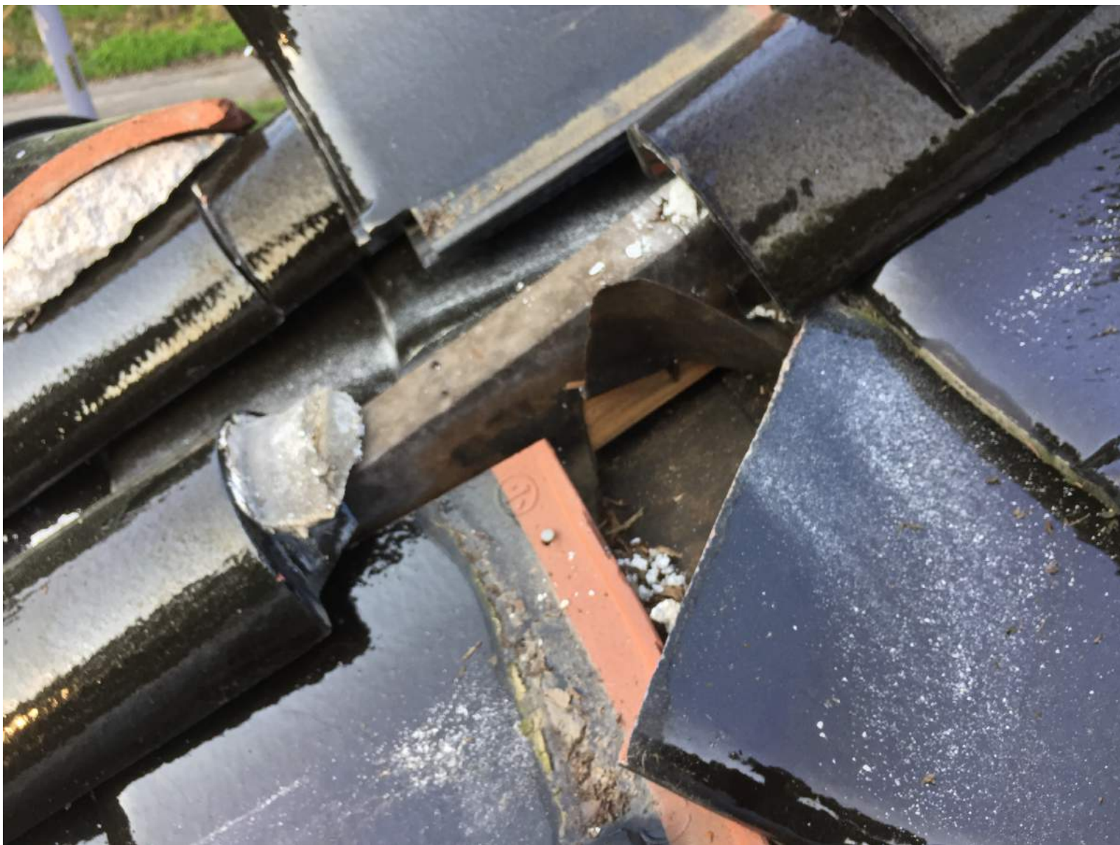
降り素丸状況 白しっくい塗りがされていないので、雨水が侵入しやすい状況です。早急に塗る必要あり。
