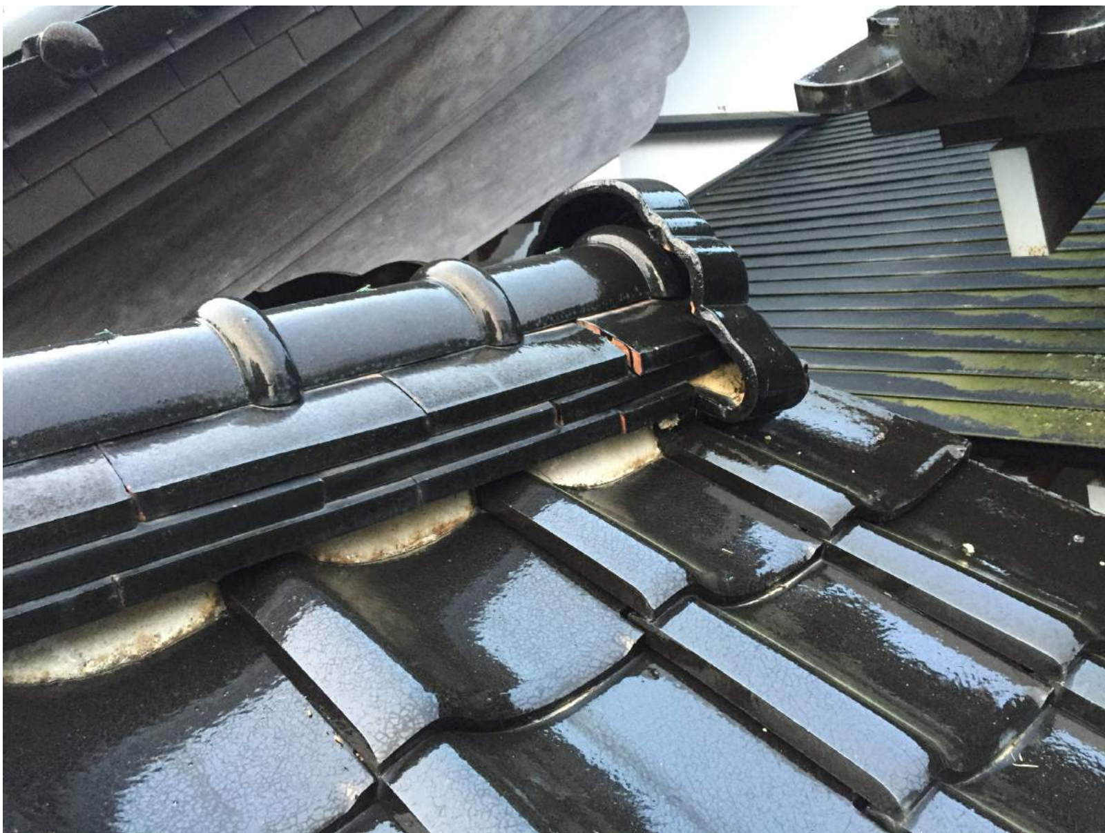
神饌殿棟状況 中のかべ土が腐敗してきており、のし瓦が出てきています。
