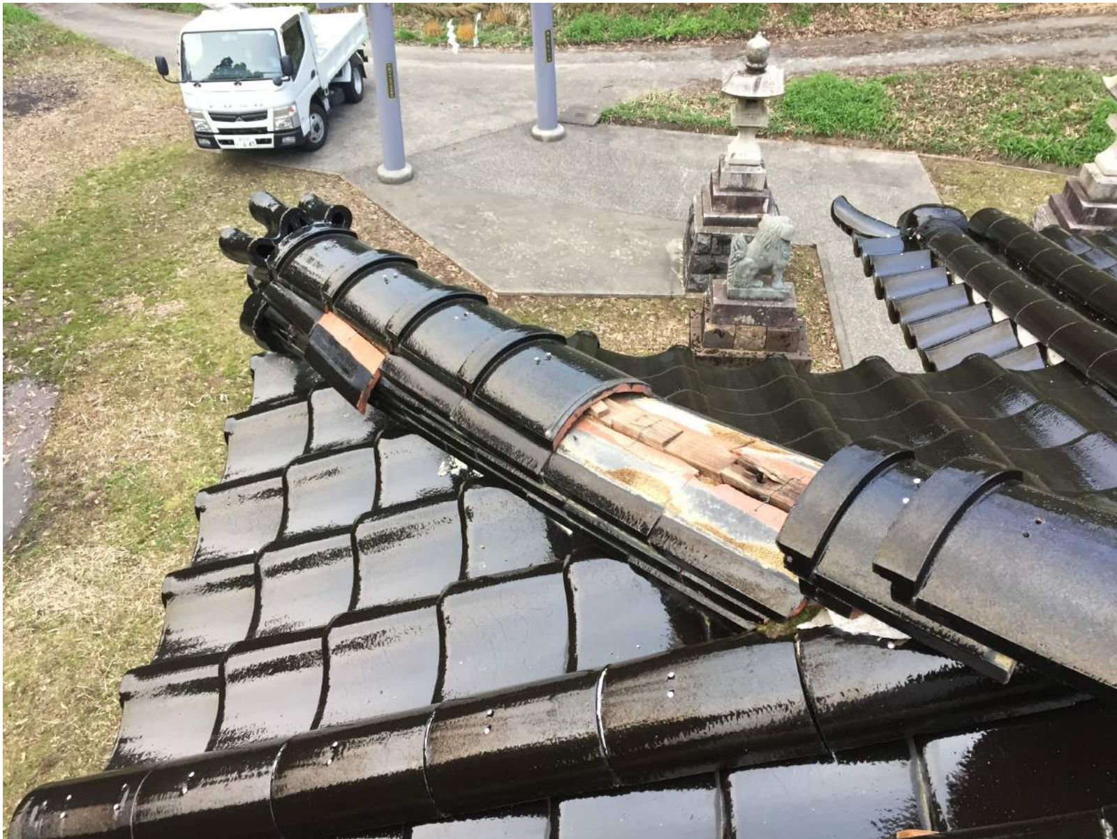
拝殿隅棟状況 かべ土が風化し、銅線及び冠止め垂木が腐敗してきています。
