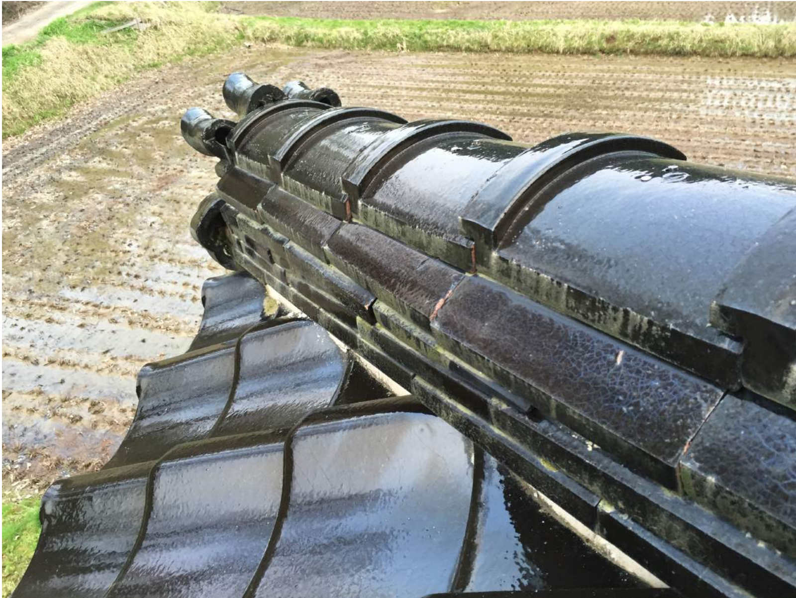
拝殿隅棟状況 上の段ののし瓦の方が出てきて、抜け落ちそうな状態です。
