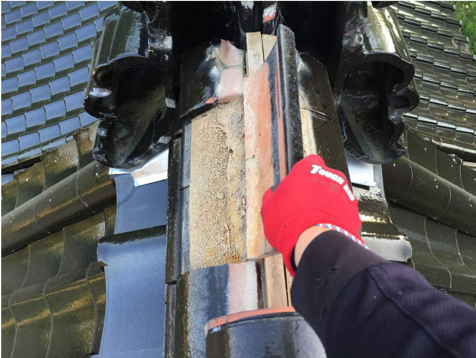
拝殿大棟状況 かべ土が腐敗し、のし瓦連結銅線は切れてきています。
