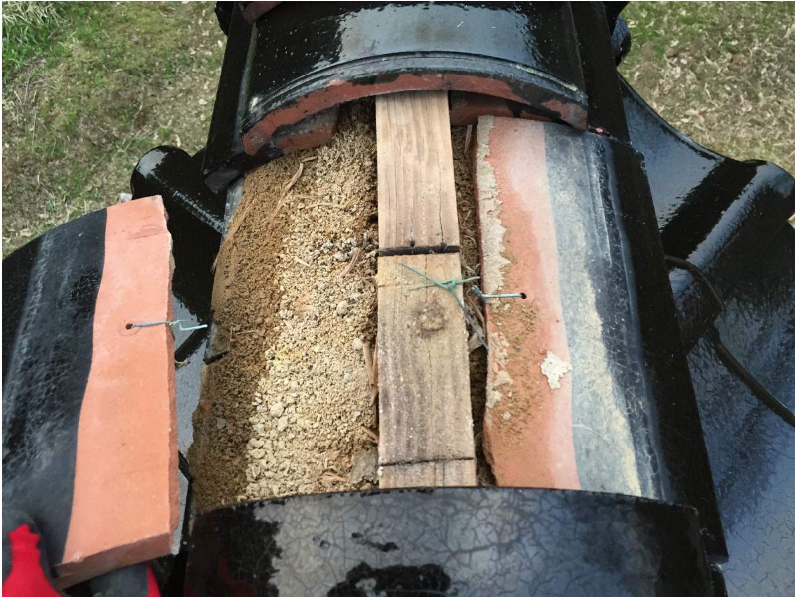
隅棟かべ土腐敗状況 かなり腐敗が進みのし瓦を維持させる役目を果たしていません。のし瓦銅線も切れています。
