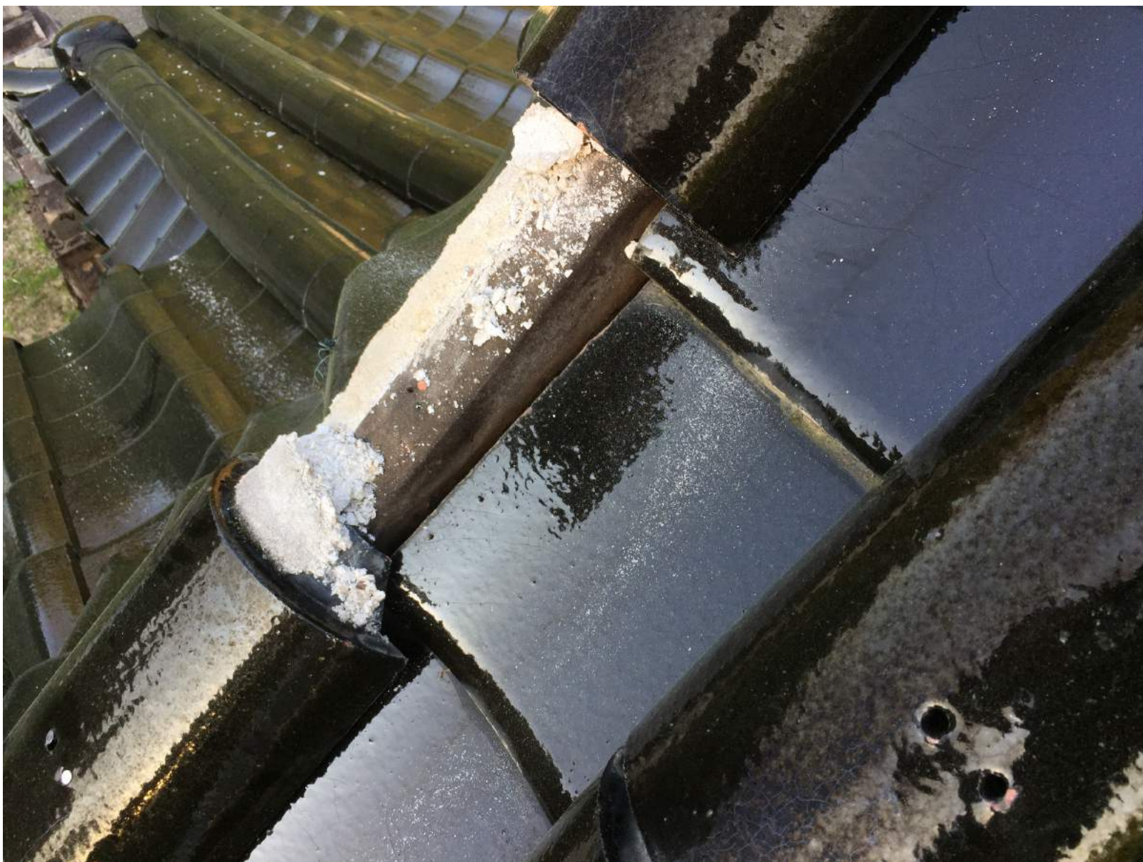
降り素丸状況 白しっくいが見えるところだけしか塗られていません。塗られている箇所は剥がれてきています。
