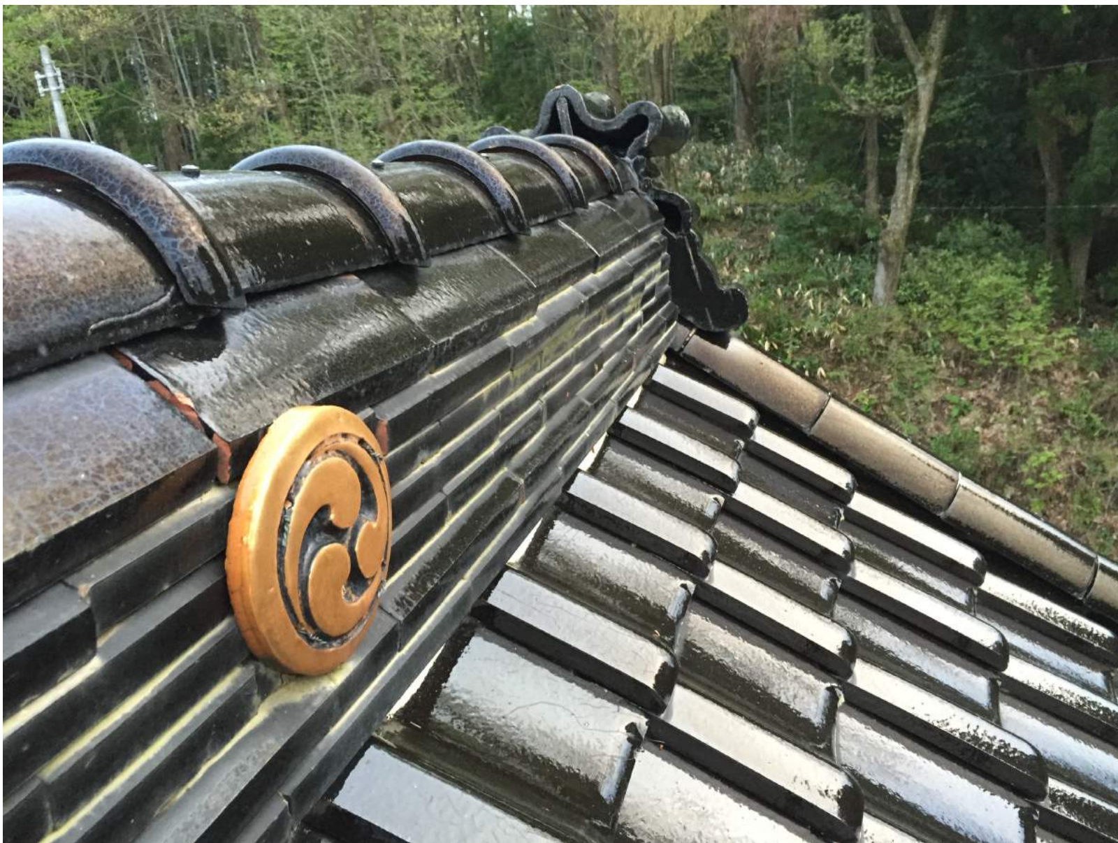
本殿棟状況 のし瓦が抜け出て落ちそうな状況です。
